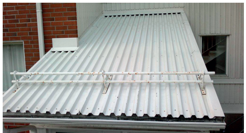
Osittain pesty tiilikatto. Puhdistetun ja puhdistamattoman alueen välillä on iso ero (yllä). Myös peltikatot on syytä pestä silloin tällöin. Puhdistus pitää katot hyvässä kunnossa (alla).
